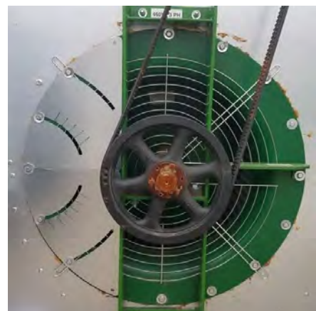
Image 3-5 – Fan intake baffles
