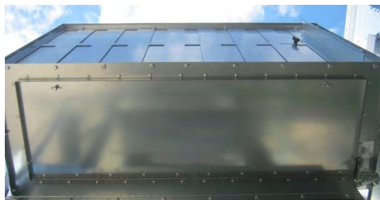
Image 34 – Inlet door on up-blast fan
